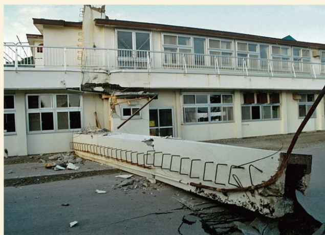
国保病院の被害状況
